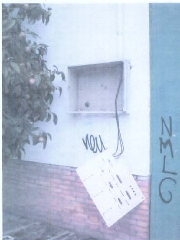
ARMARIO ACOMETIDA PATIO 8
