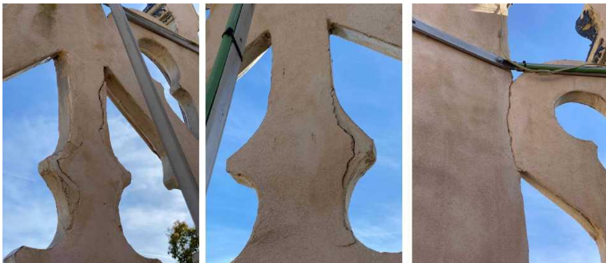
Fisuras y grietas con peligro de desprendimiento.
