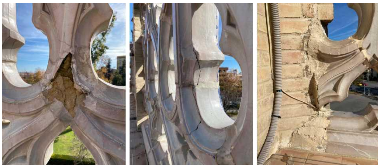
Pérdidas de morteros de reconstrucción, aparición de grietas. Repasos de morteros inacabados
