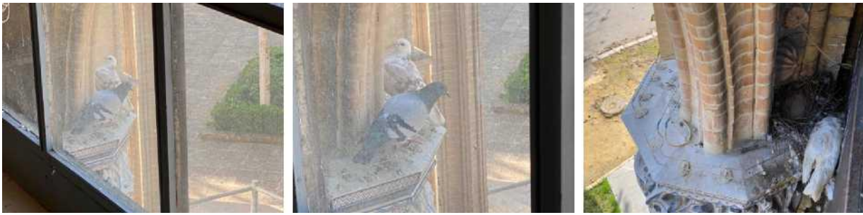
Mal funcionamiento del sistema anti-aves.
