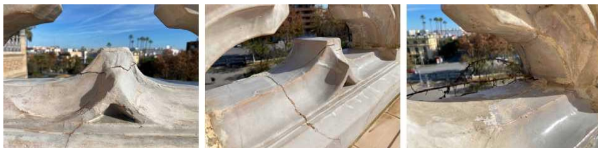
Aparición de grietas en morteros de reconstrucción
