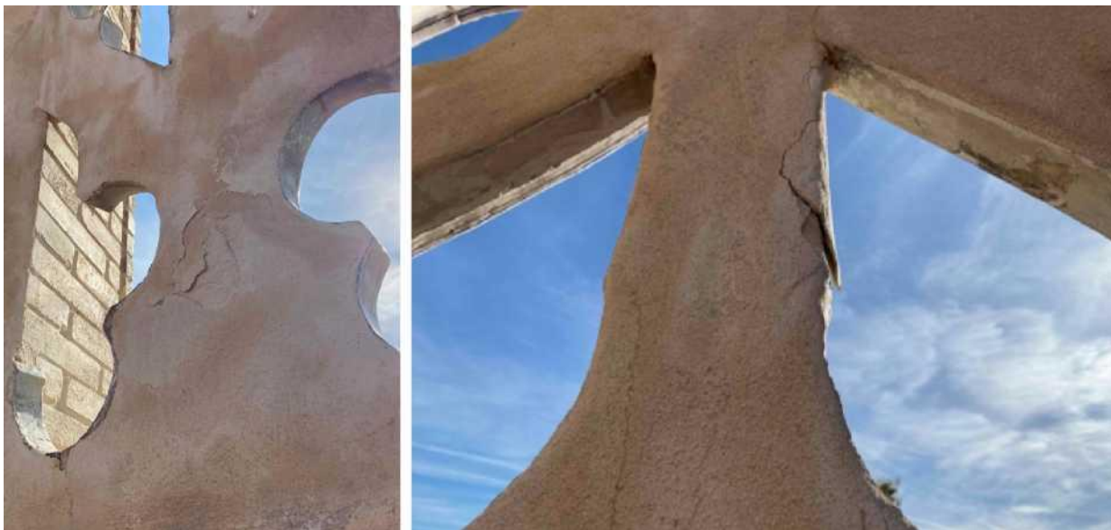
Grietas y abolsamiento de los morteros aplicados. Levantamientos con peligro de desprendimiento.
