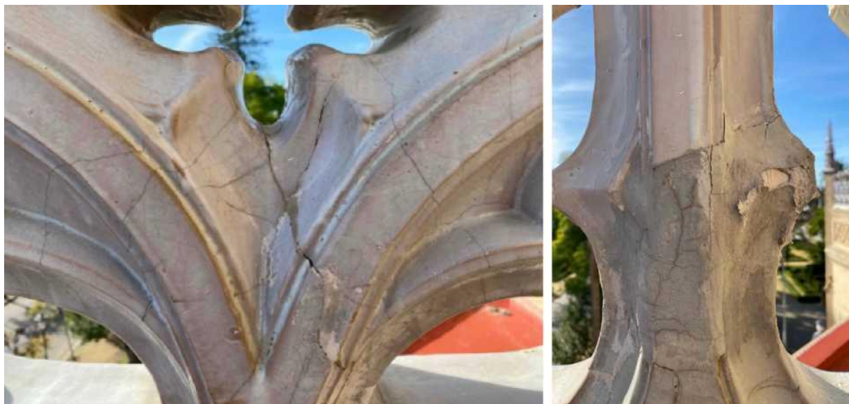
Grietas y levantamiento en reintegraciones de color
