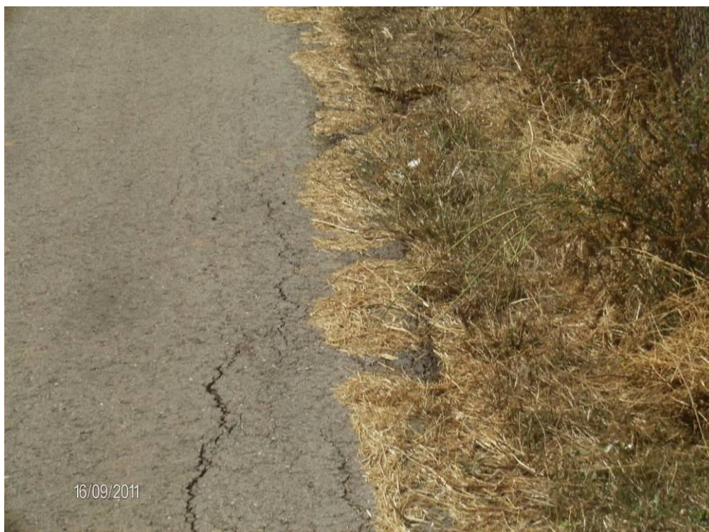
Detalle de grietas que presenta el carril bici.
