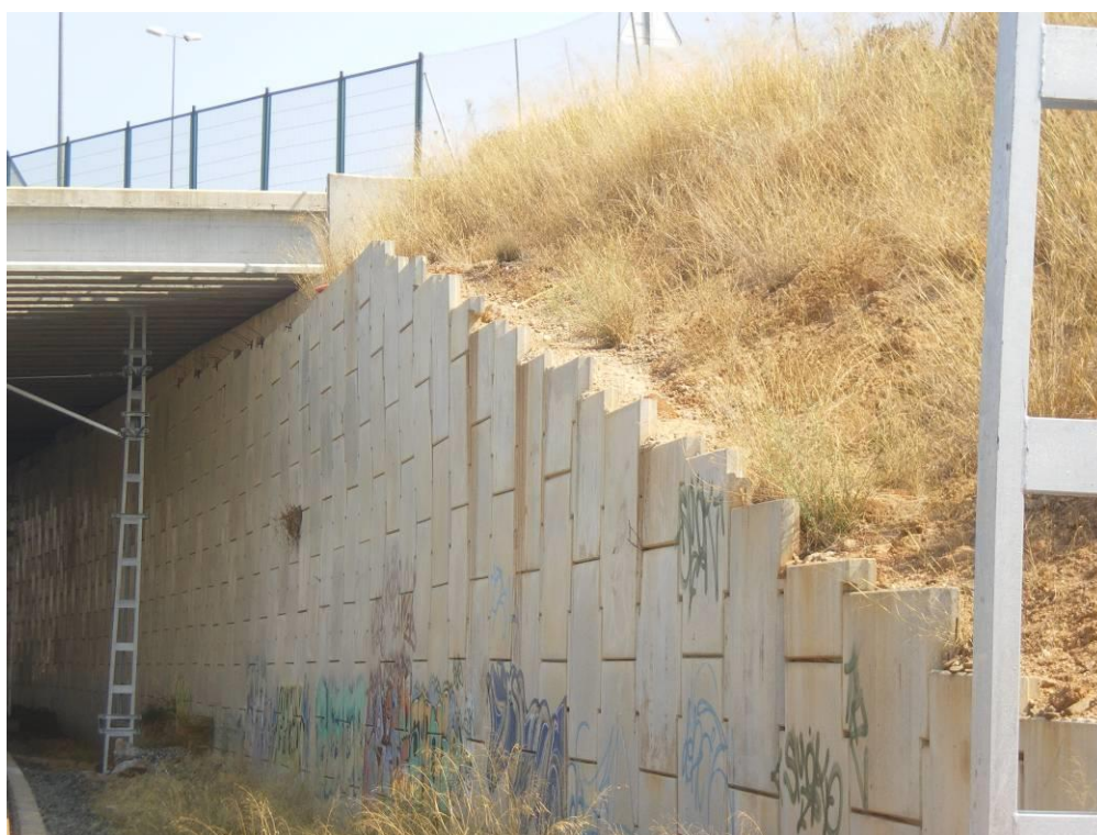
Detalle de desplazamiento de algunos paños del muro de tierra armada.
